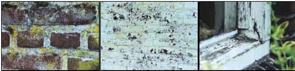
Den ødelæggende effekt af fugten er meget synlig.
